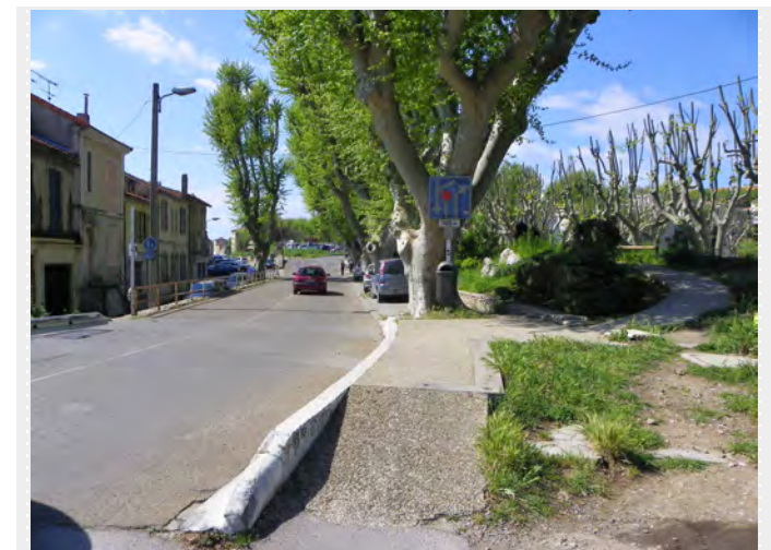
Rupture du jalonnement piéton
