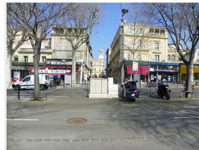
Un transformateur électrique intrusif
